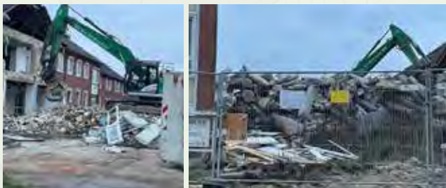
Bevor es besser wird, wird es erst einmal schlimmer – der Altbau wurde abgerissen. Aktuell wird nun hart daran gearbeitet, diese Trümmerlandschaft in einen schönen Ort für unsere Pflegebedürftigen zu verwandeln.
